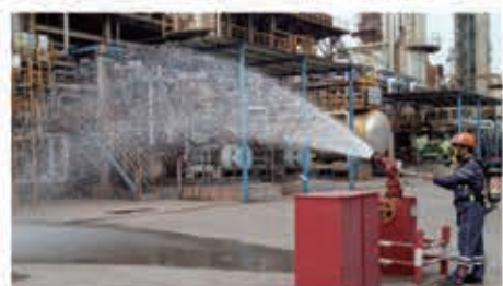
启动消防设施
